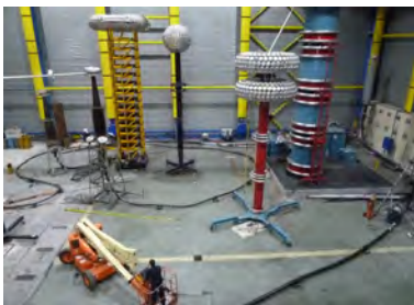
Le laboratoire de Gron réalise les essais sur les câbles THT.
